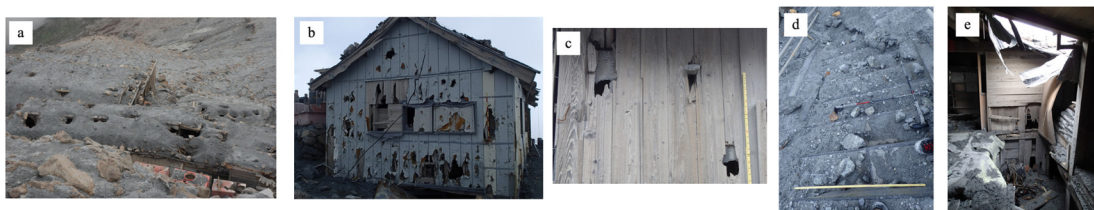
図1 2015年8月19日および20日に調査した2014年御嶽山噴火で生じた山小屋などの被害の様子 (a: 御嶽頂上山荘の屋根被害, b: 御嶽神社奥社祈禱所の壁被害, c: 王滝頂上山荘の壁被害, d: 御嶽頂上山荘から御嶽神社奥社に繋がる階段の噴石飛散状況, e: 御嶽剣ヶ峰山荘の内部被害) [9]
