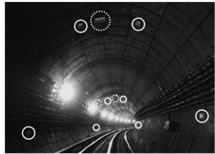
図2 WSNを設置した現場の状況（ロンドン地下鉄） [5, 6]
